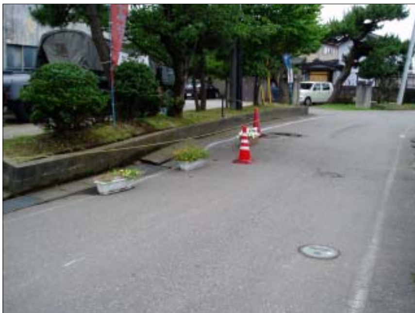
写真名：関町-3、道路の沈下 撮影箇所：関町地内、枇杷島小学校 撮影日：2007年 7月 22日 コメント：小学校前の道路が大きく沈下し、その両側にある植え込みや水路も大きく変形している状況
