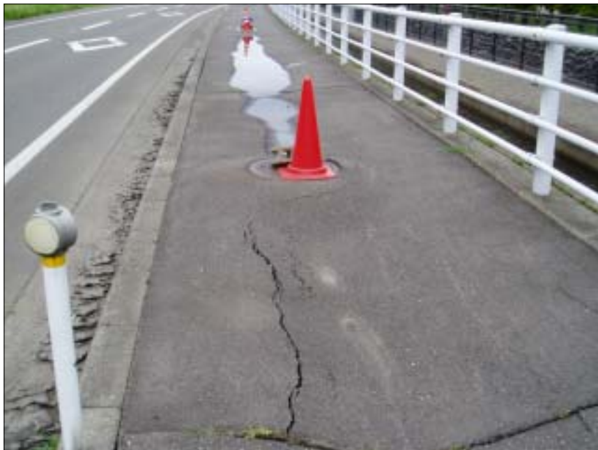
写真名：新道-2、下水管路の沈下 撮影箇所：新道地内、南中学校 撮影日：2007年 7月 22日 コメント：中学校前の農業集落排水の管路部分が沈下して水溜りを作っている状況
