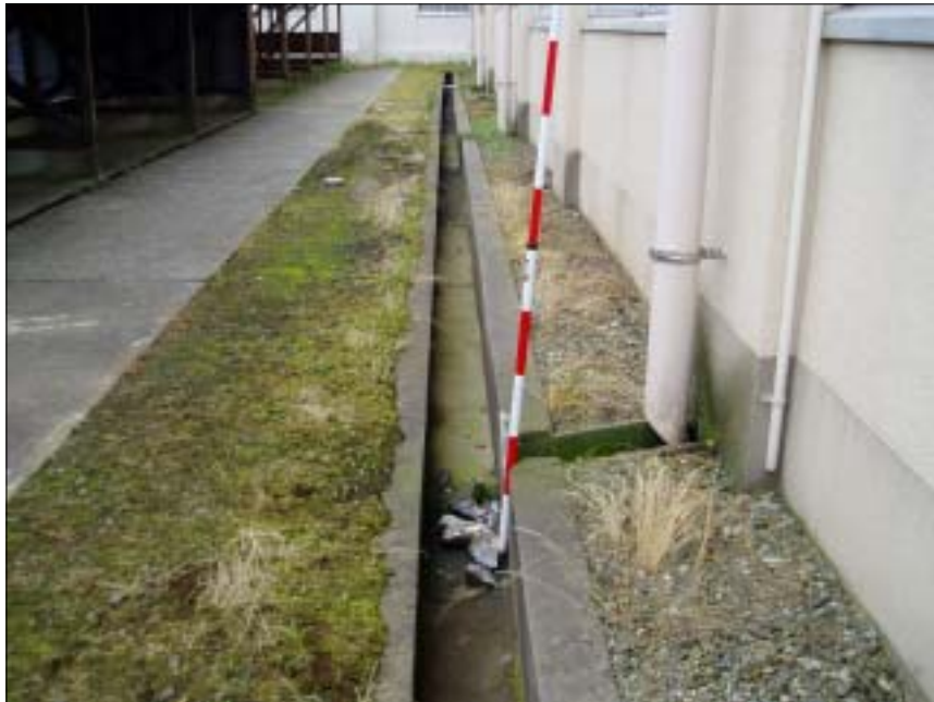
写真名：元城-2、排水路の変形 撮影箇所：元城町、柏崎総合高校 撮影日：2007年 7月 22日 コメント：奥の部分で排水路が校舎とは反対側に変形している状況
