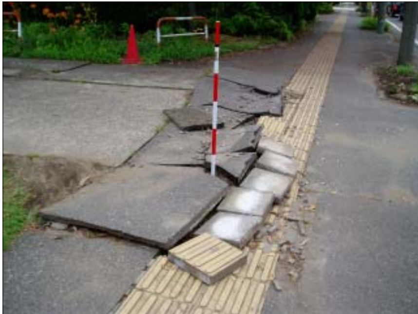
写真名：四谷1-1、歩道の損傷 撮影箇所：四谷1丁目、白竜公園入口 撮影日：2007年 7月 22日 コメント：公園入口の歩道部分のアスファルトや点字ブロックが壊れて捲れている状況
