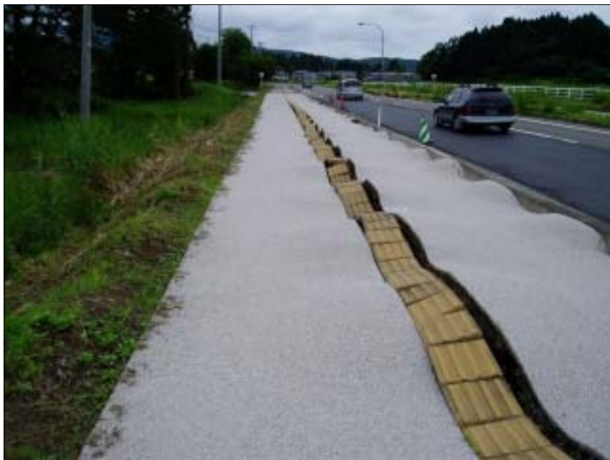
写真名：堀-7、道路歩道部の 湾曲 撮影箇所：堀地内、県道73号 撮影日：2007年 7月 22日 コメント：沈下変形箇所 に隣接して、歩道が大きく見事に 波状に湾曲した箇所が見られ た。軽量盛土の圧縮に伴う影 響か?西方向を臨む。
