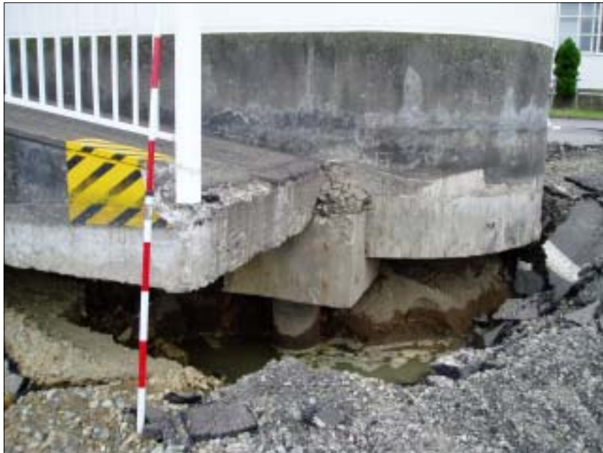
写真名：畔屋-2、建物周辺の 沈下 撮影箇所：畔屋地内、かしわ 荘 撮影日：2007年 7月 22日 コメント：隣接する法面の沈 下変状に伴い、建物周辺でも 大きな沈下が生じている状況
