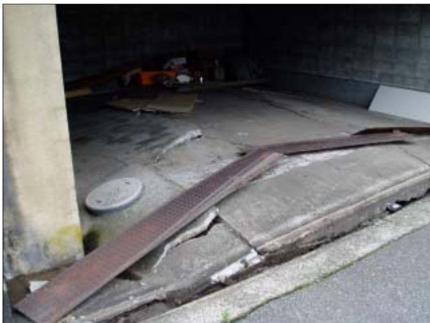
写真名：四谷2-1、車庫底面の盛上り 撮影箇所：四谷2丁目地内 撮影日：2007年 7月 22日 コメント：古砂丘の緩傾斜地に立つ車庫。地震動によって斜面下方に押されて、底面が大きく盛上っている状況
