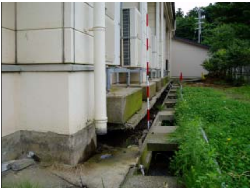
写真名：常盤台-1、東側の段差 撮影箇所：常盤台地内、剣野小学校 撮影日：2007年 7月 22日 コメント：東側の鵜川に向けて地盤が沈下し、校舎との間に段差=約30cmが生じている状況
