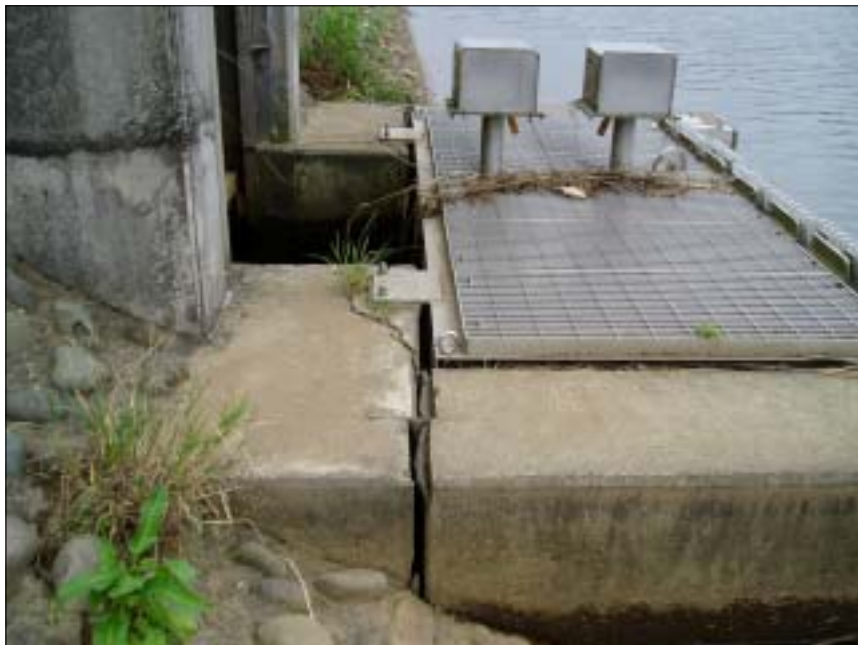
写真名：元城-5、排水施設の損傷 撮影箇所：元城町地内 撮影日：2007年 7月 22日 コメント：新金曲輪橋に隣接する排水施設の損傷状況
