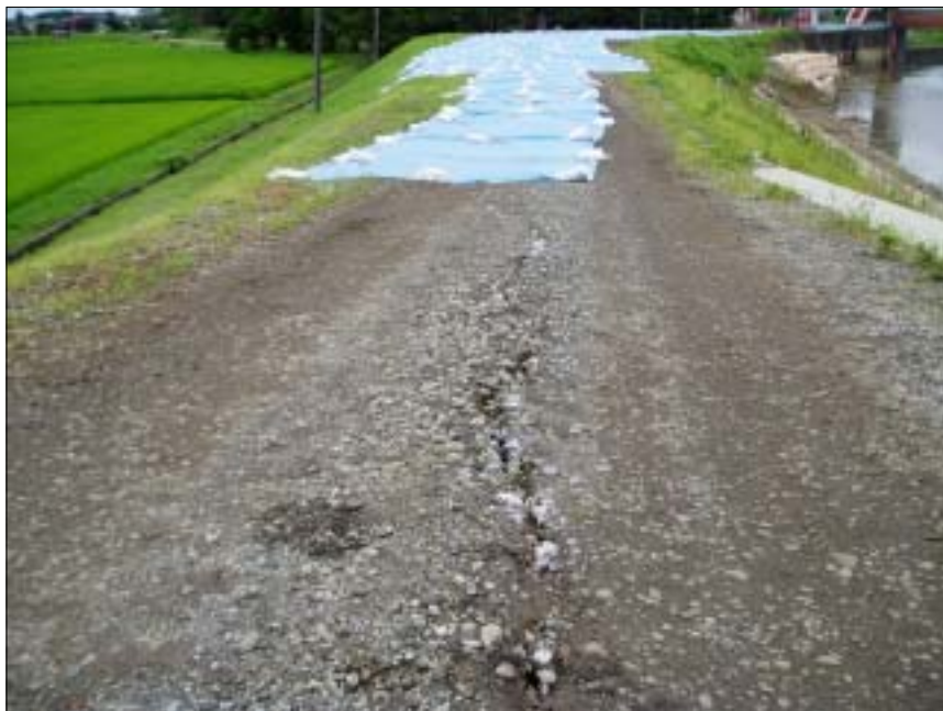
写真名：中道-4、堤防の亀裂 撮影箇所：中道地内、大正橋 撮影日：2007年 7月 22日 コメント：大正橋下流側の左岸堤防には、大きな亀裂が入っている。ブルーシートで養生をしている状況
