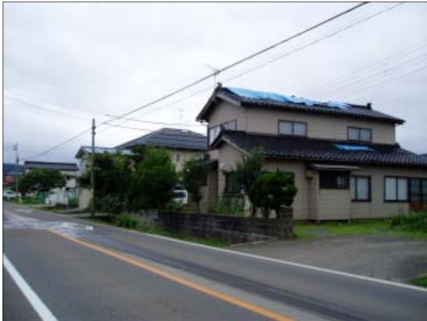
写真名：上方-2、屋根の損傷 撮影箇所：上方地内 撮影日：2007年 7月 22日 コメント：上方地内では、 所々で屋根に損傷が見られ、 ブルーシートが掛かっている 状況
