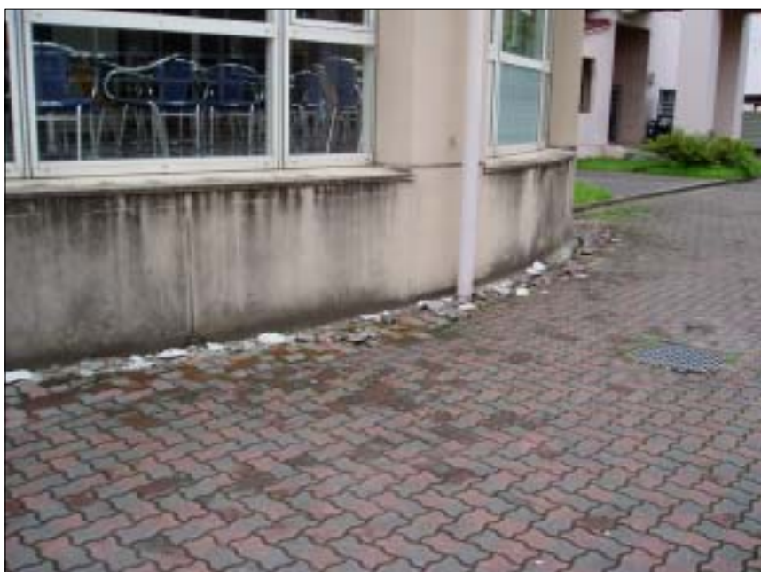
写真名：軽井川-3、敷きブロックの破損 撮影箇所：軽井川地内、新潟産業大学 撮影日：2007年 7月 22日 コメント：食堂脇のインターロッキングブロックが破損している状況
