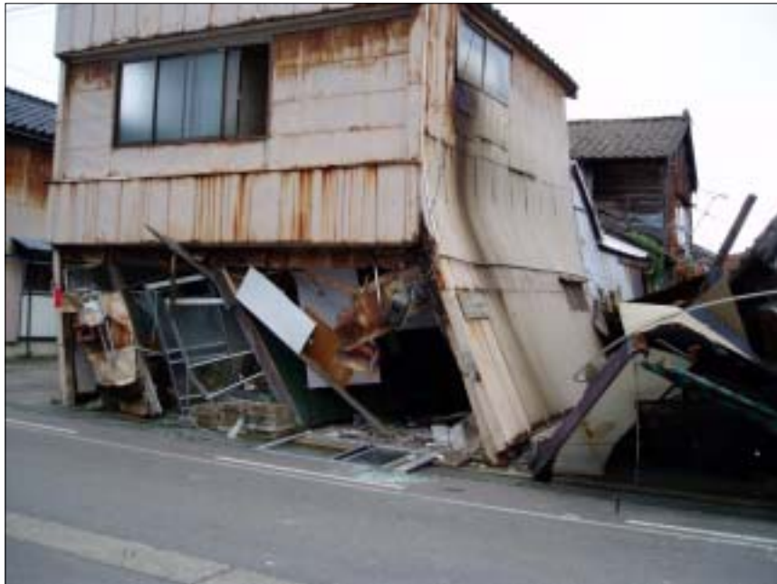
写真名：東本町-5、倒壊寸前の建物 撮影箇所：東本町地内 撮影日：2007年 7月 22日 コメント：古い建物が倒壊寸前となっている。周辺では、赤紙や黄紙を張られた家屋が5割近くに達している。
