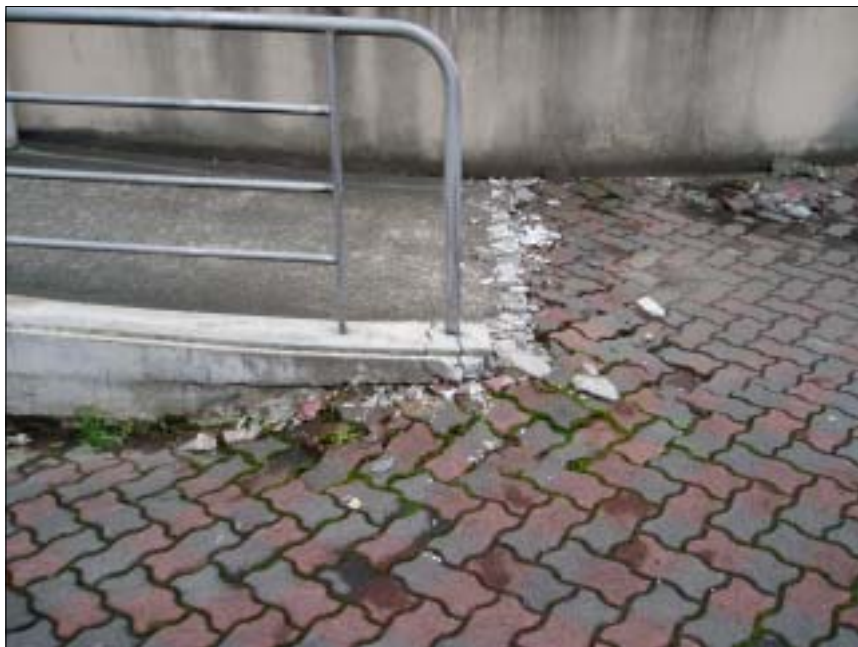
写真名：軽井川-4、敷きブロックの破損 撮影箇所：軽井川地内、新潟産業大学 撮影日：2007年 7月 22日 コメント：食堂脇のインターロッキングブロックが破損している状況
