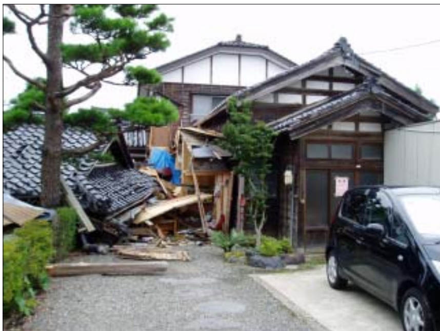
写真名：中田-6、家屋の被災 状況 撮影箇所：中田地内 撮影日：2007年 7月 22日 コメント：北鯖石小学校の周 辺では、古い建物を中心に倒 壊したり、大きく傾いている 建物が多い。
