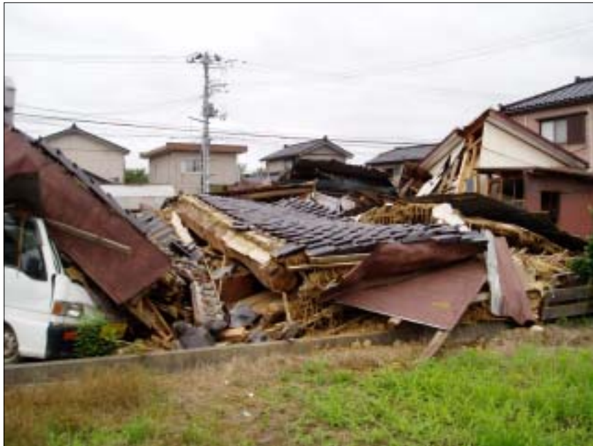
写真名：関町-5、倒壊した建物 撮影箇所：関町地内 撮影日：2007年 7月 22日 コメント：反対側からの写真 で、建物で軽四が押し潰され ている状況
