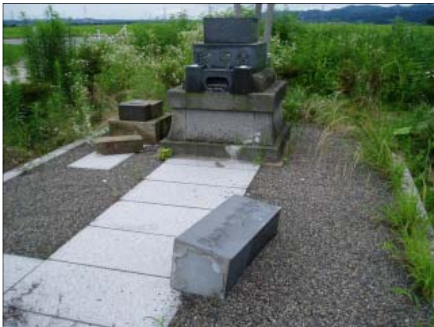
写真名：中田-7、墓石の転落 撮影日：2007年 7月 22日 コメント：北鯖石小学校の裏にある墓地では、古いお墓を中心に倒れているものが多い。
