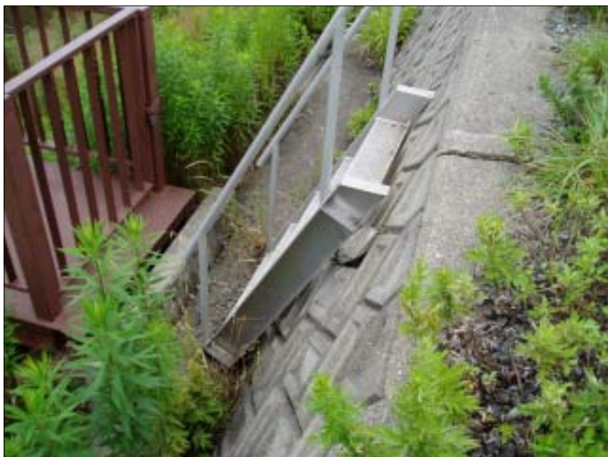
写真名：元城-6、排水施設階段の損傷 撮影箇所：元城町地内 撮影日：2007年 7月 22日 コメント：排水施設のゲートへ行く階段が、ブロック積から外れている状況
