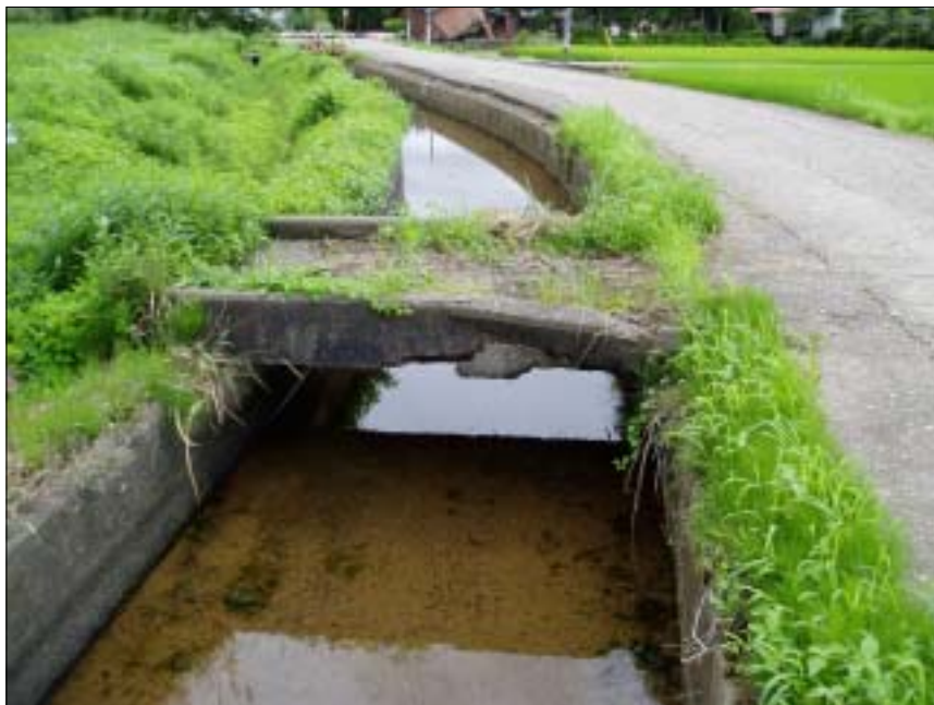
写真名：中田-1、床版橋の破損 撮影箇所：中田地内 撮影日：2007年 7月 22日 コメント：畔屋地区と中田地区の境界を流れる用水に掛かっている床版橋は、圧縮によって破壊している。
