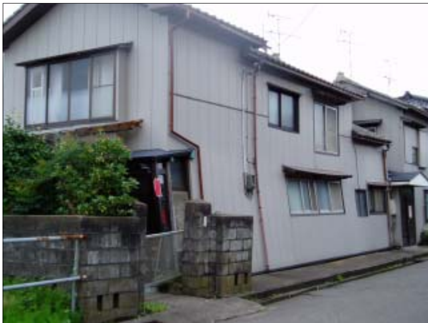
写真名：東本町-7、倒壊寸前の建物 撮影箇所：東本町地内 撮影日：2007年 7月 22日 コメント：比較的新しいように見えるが、倒壊寸前となっている建物。入口には赤紙が張られている。
