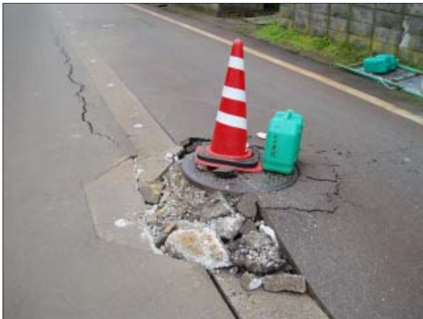
写真名：比角1-4、マンホールの浮上り 撮影箇所：比角1丁目地内 撮影日：2007年 7月 22日 コメント：マンホールが15cmほど浮上っている状況。
