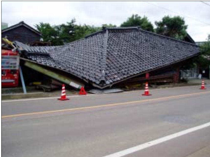
写真名：中田-5、家屋の倒壊 撮影箇所：中田地内 撮影日：2007年 7月 22日 コメント：北鯖石小学校の周 辺では、古い建物を中心に倒 壊したり、大きく傾いている 建物が多い。
