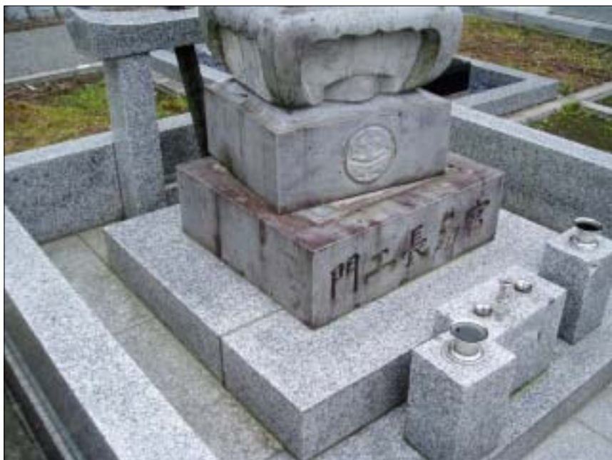
写真名：堀-12、墓石の移動 撮影箇所：堀地内、柏崎墓園 撮影日：2007年 7月 22日 コメント：古い墓石が移動している状況
