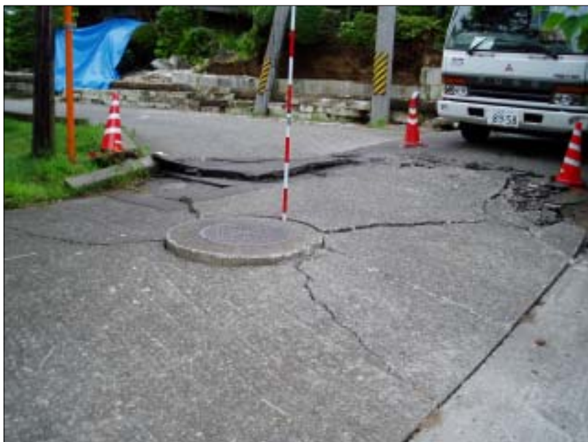
写真名：四谷1-2、マンホール周辺の沈下 撮影箇所：四谷1丁目、白竜公園横 撮影日：2007年 7月 22日 コメント：周辺が沈下してマンホールが飛び出し、道路に亀裂が生じている状況
