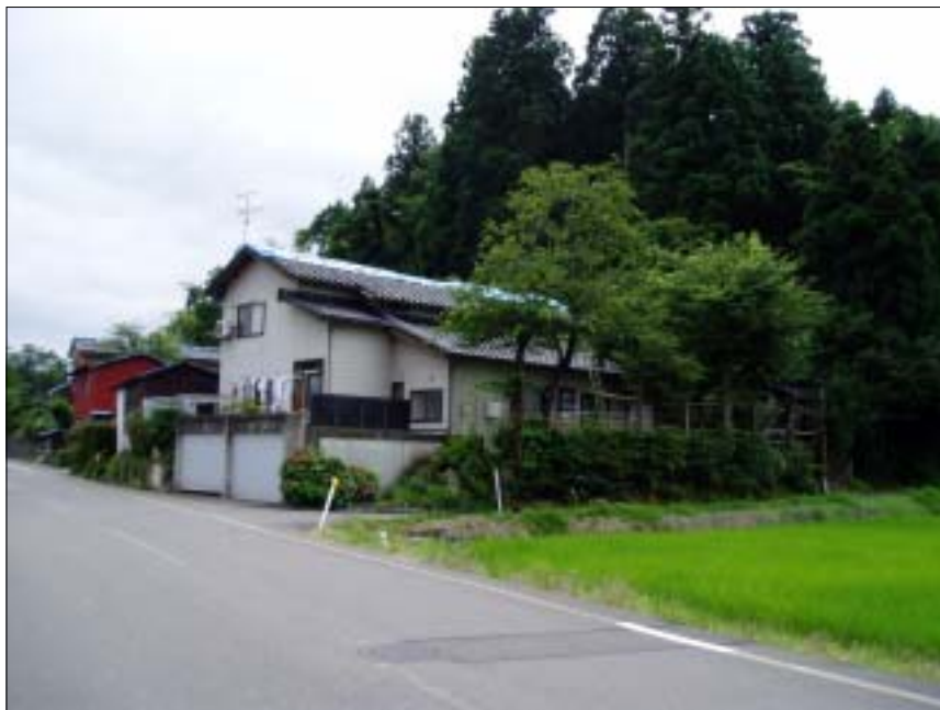
写真名：畔屋-7、家屋の被災状況 撮影箇所：畔屋地内、丘陵北側 撮影日：2007年 7月 22日 コメント：畔屋北側の丘陵と接する部分では、屋根など家屋の被害が散見される
