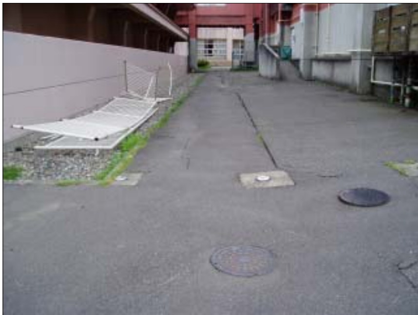
写真名：軽井川-1、下水管路の沈下 撮影箇所：軽井川地内、新潟産業大学 撮影日：2007年 7月 22日 コメント：校舎間に布設している下水管路の部分が沈下している状況。左側には、地震によって破損したと思われる手摺が置かれている。
