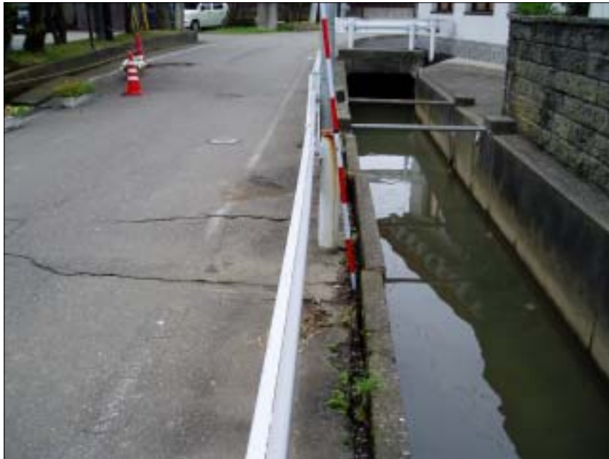
写真名：関町-2、水路の段差変形 撮影箇所：関町地内、枇杷島小学校 撮影日：2007年 7月 22日 コメント：小学校前の水路に段差などの変状が生じている状況
