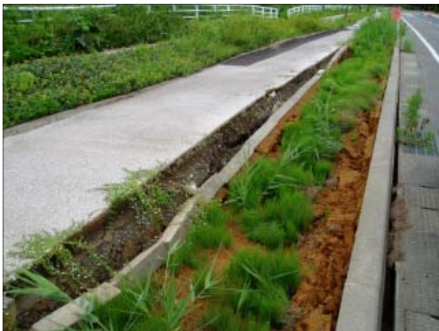
写真名：堀-9、路側帯の沈下 変形 撮影箇所：堀地内、県道73号 撮影日：2007年 7月 22日 コメント：歩道湾曲部の道路 を挟んで反対側の状況
