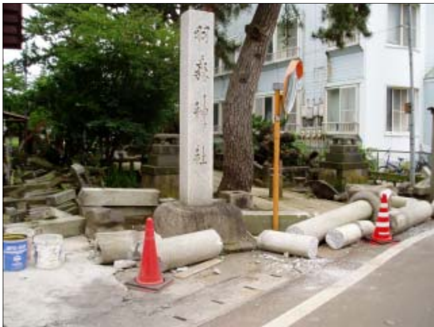
写真名：比角1-1、鳥居の倒壊 撮影箇所：比角1丁目地内 撮影日：2007年 7月 22日 コメント：羽森神社前の鳥居や玉垣が倒壊している状況。古い石造物はかなりの確立で倒壊している。
