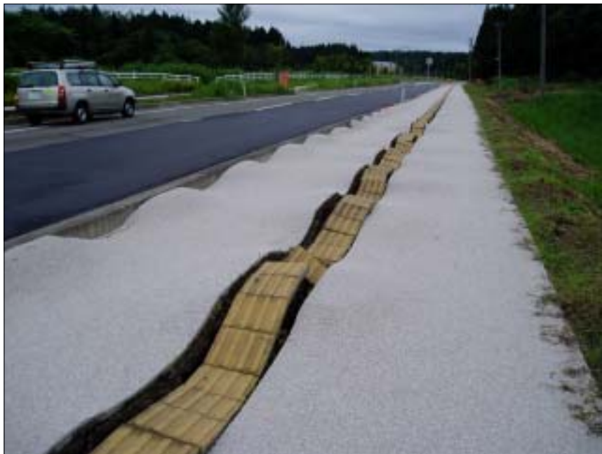
写真名：堀-8、道路歩道部の 湾曲 撮影箇所：堀地内、県道73号 撮影日：2007年 7月 22日 コメント：沈下変形箇所 に隣接して、歩道が大きく見事に 波状に湾曲した箇所が見られ た。軽量盛土の圧縮に伴う影 響か?東方向を臨む。
