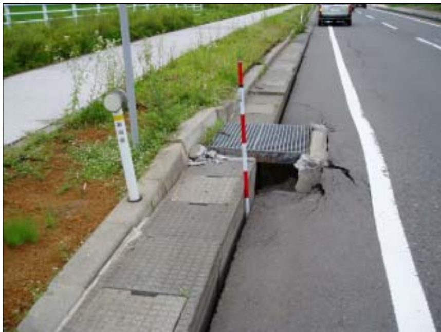
写真名：堀-1、道路の沈下変形 撮影箇所：堀地内、県道73号 撮影日：2007年 7月 22日 コメント：道路の沈下変形に伴って、排水路や柵が飛び出している状況
