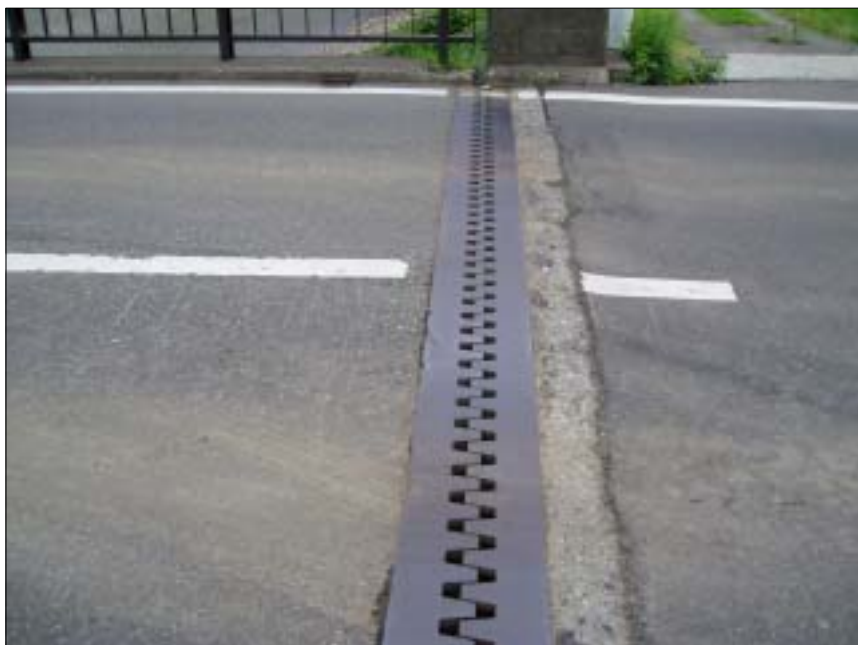
写真名：中道-6、橋梁ジョイント部の開き 撮影箇所：中道地内、大正橋 撮影日：2007年 7月 22日 コメント：左岸側のジョイントは、橋桁と橋台がぶつかって、損傷や隙間が生じている
