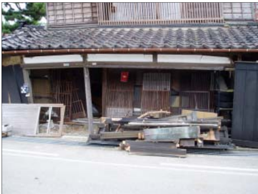
写真名：東本町-3、倒壊寸前の家屋 撮影箇所：東本町地内 撮影日：2007年 7月 22日 コメント：古い木造住宅は、かなりの数が倒壊し、倒壊を免れても危険な状態にある。
