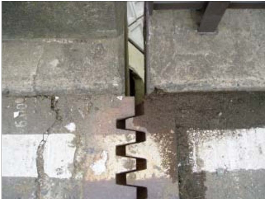
写真名：中道-5、橋梁ジョイント部の開き 撮影箇所：中道地内、大正橋 撮影日：2007年 7月 22日 コメント：左岸側のジョイントは、橋桁と橋台がぶつかって、損傷や隙間が生じている
