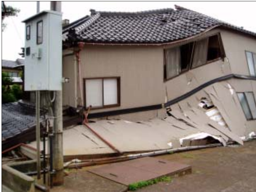
写真名：比角1-5、家屋の倒壊 撮影箇所：比角1丁目地内 撮影日：2007年 7月 22日 コメント：新しいように見えるが、実際は古い家を改修した建物と思われる。1階が完全に押し潰されている。
