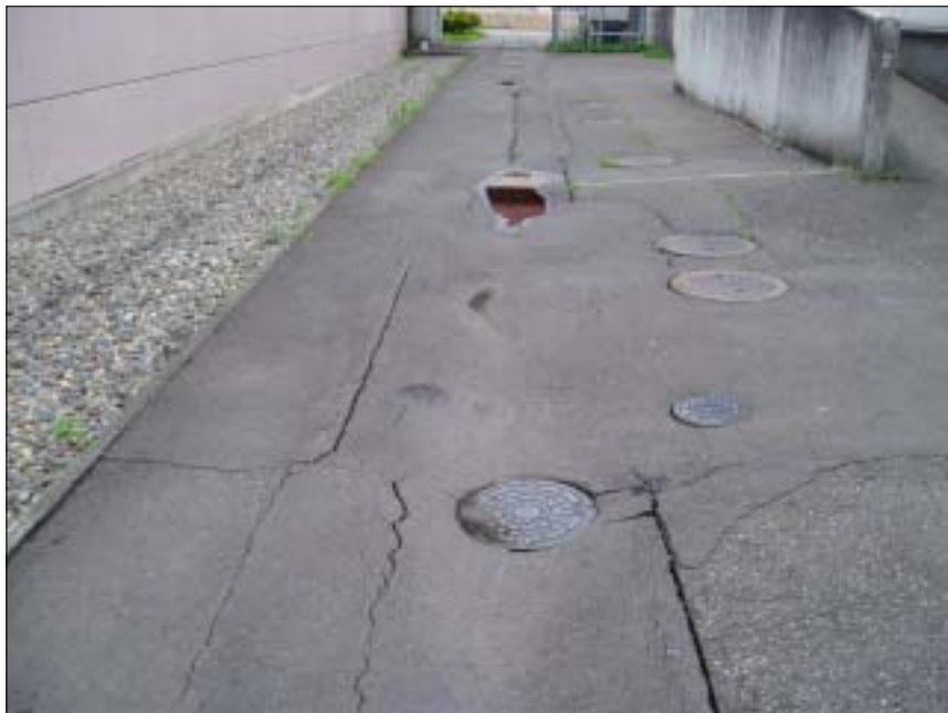
写真名：軽井川-2、下水管路の沈下 撮影箇所：軽井川地内、新潟産業大学 撮影日：2007年 7月 22日 コメント：校舎の間を走っている下水管路が沈下している状況の拡大。
