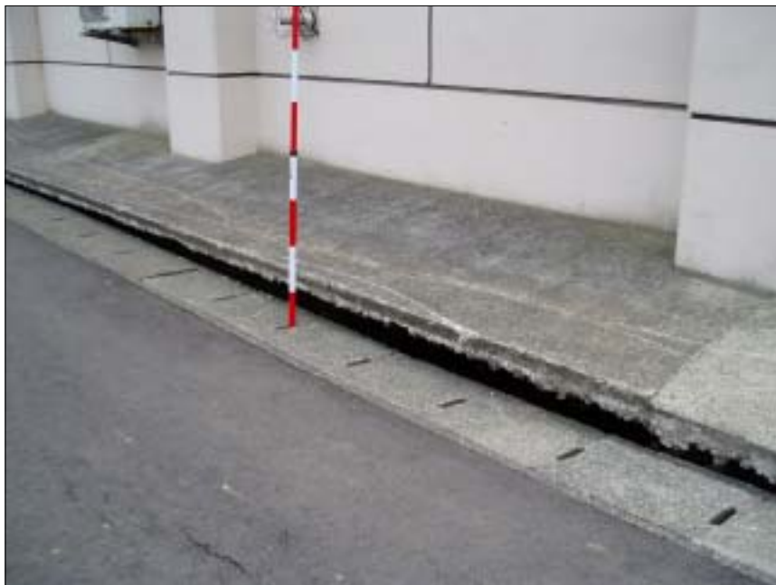
写真名：扇町-1、建物周辺の沈下 撮影箇所：扇町、比角小学校 撮影日：2007年 7月 22日 コメント：校舎北側が沈下し、側溝と校舎の間に15cmほどの段差が生じている状況。古砂丘下の扇町では、古砂丘上の旧市外地と比較して、被害がやや少ないように思われる。
