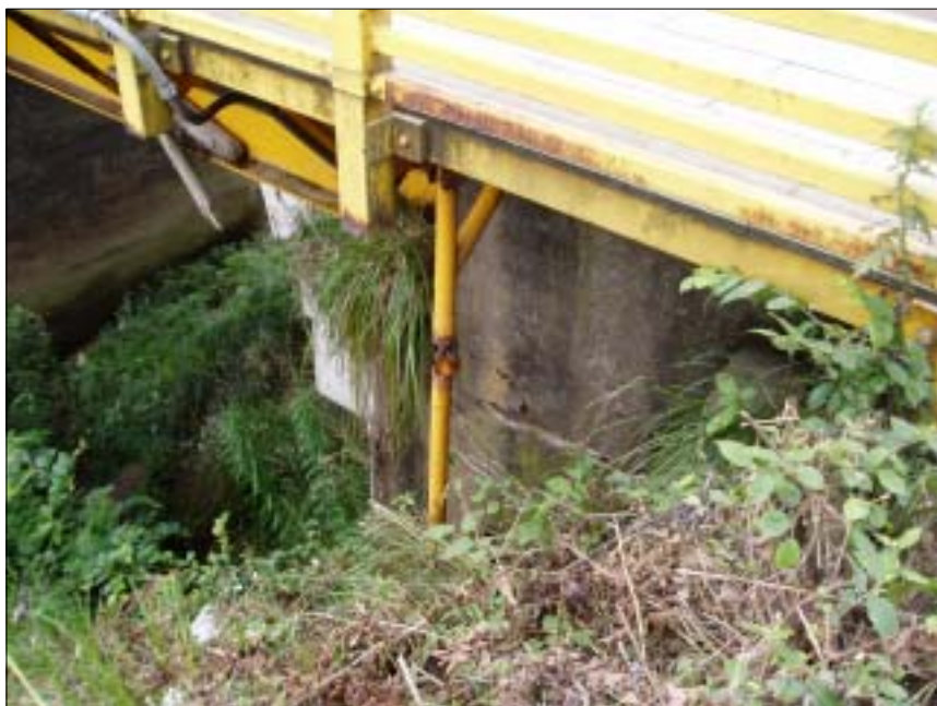
写真名：中田-15、橋台の損傷 撮影箇所：中田地内、県道11号 撮影日：2007年 7月 22日 コメント：鯖石川に掛かる橋梁の右岸側橋台では、地震によって橋台コンクリートが欠けるなどの損傷が見られる。
