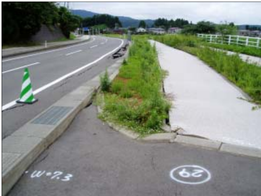
写真名：堀-2、道路の沈下変形 撮影箇所：堀地内、県道73号 撮影日：2007年 7月 22日 コメント：道路が大きく沈下して、可変側溝が飛び出している状況、西方向を臨む
