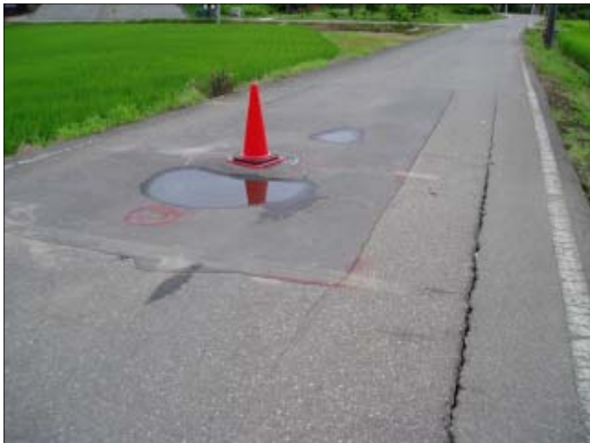
写真名：畔屋-5、下水管路の沈下 撮影箇所：畔屋地内、丘陵南側 撮影日：2007年 7月 22日 コメント：下水管路のマンホールの前後で、比較的大きな沈下が生じている。
