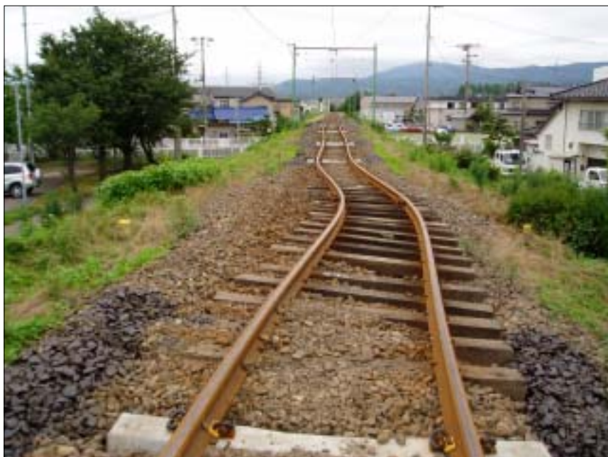
写真名：四谷1-5、鉄道の湾曲 撮影箇所：四谷1丁目 撮影日：2007年 7月 22日 コメント：倒壊の周辺で、鉄道が大きく湾曲している状況、南側を望む。
