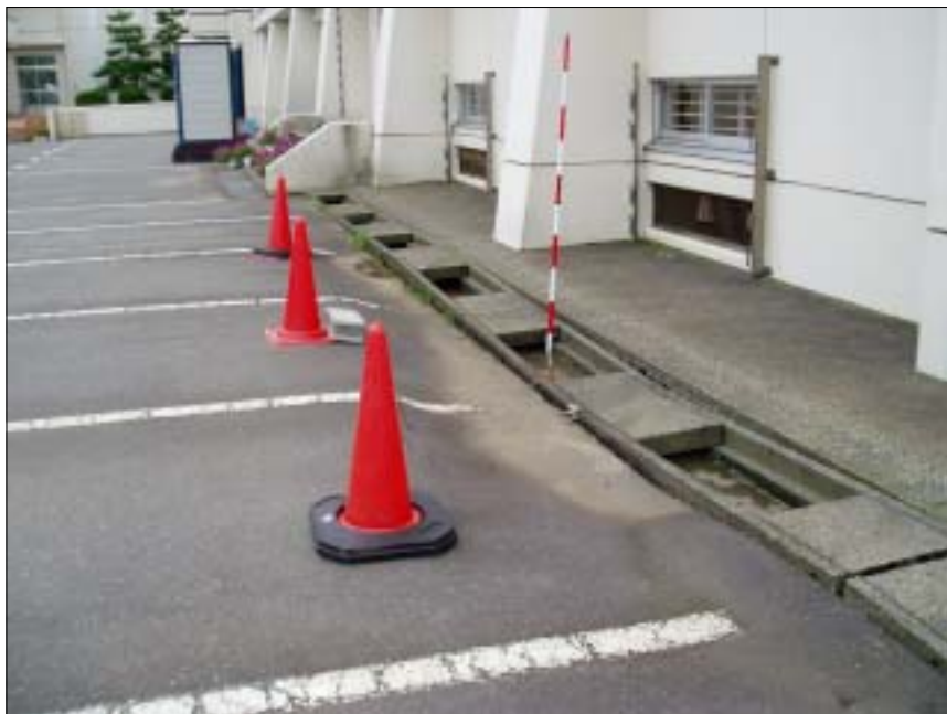
写真名：新道-1、排水路の沈下 撮影箇所：新道地内、南中学校 撮影日：2007年 7月 22日 コメント：体育館横の排水路が沈下して変形している状況。これ以外にも小さな変状は見られるが、外見上はそれほど大きな被害は見られない
