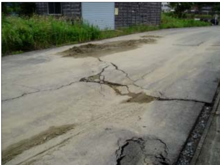
写真名：中田-12、液状化による噴砂 撮影箇所：中田地内 撮影日：2007年 7月 22日 コメント：道路上に残っている噴砂の跡とクラック
