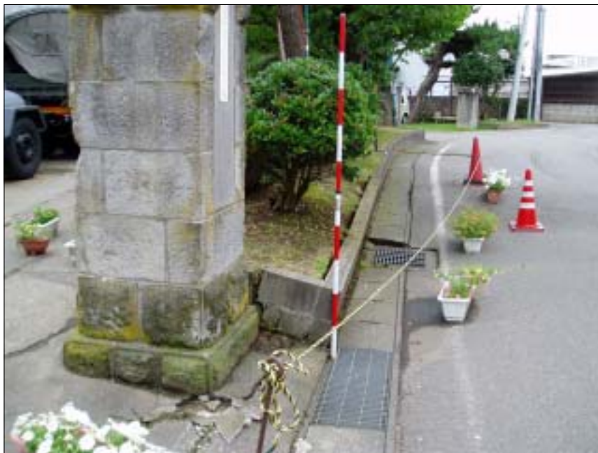
写真名：関町-1、植込みの変状 撮影箇所：関町地内、枇杷島小学校 撮影日：2007年 7月 22日 コメント：校門前の植え込みのブロックが傾斜、沈下している状況
