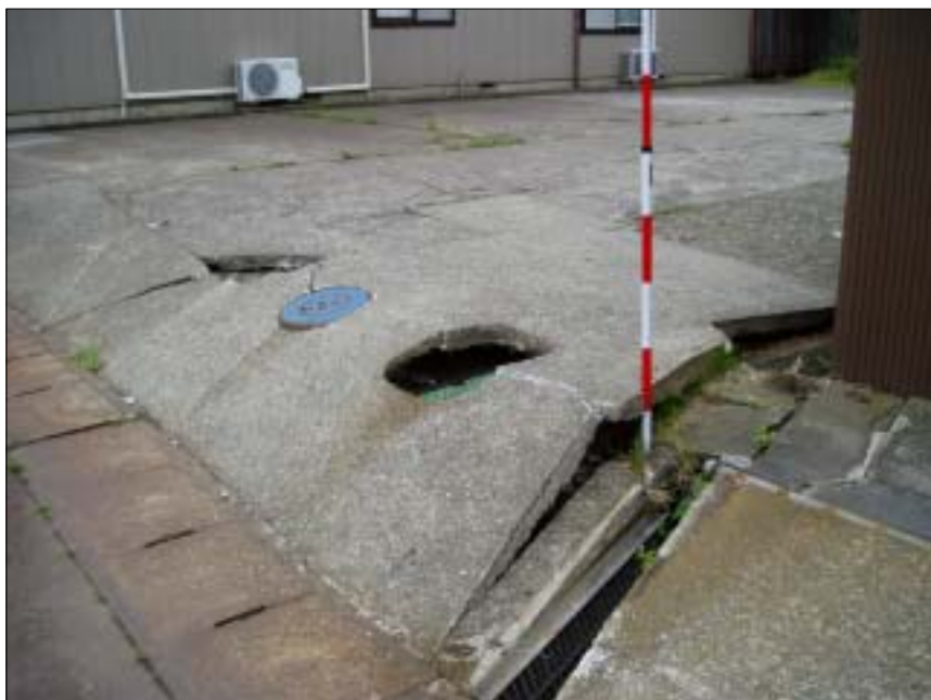
写真名：東本町-9、舗装の隆起 撮影箇所：東本町地内 撮影日：2007年 7月 22日 コメント：ガス管などの周辺の舗装コンクリートが大きく持ち上がっている状況。
