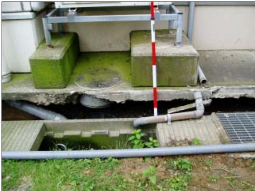
写真名：常盤台-2、下水排水の破損 撮影箇所：常盤台地内、剣野小学校 撮影日：2007年 7月 22日 コメント：校舎東側で地盤が沈下したため、下水や雨水などの排水管が破断している状況
