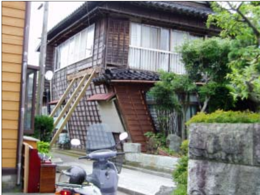
写真名：東本町-8、倒壊寸前の建物 撮影箇所：東本町地内 撮影日：2007年 7月 22日 コメント：古い建物が倒壊寸前となっている。道路への倒壊を防ぐために支えがしてあるが、大きな余震が来れば危険である。
