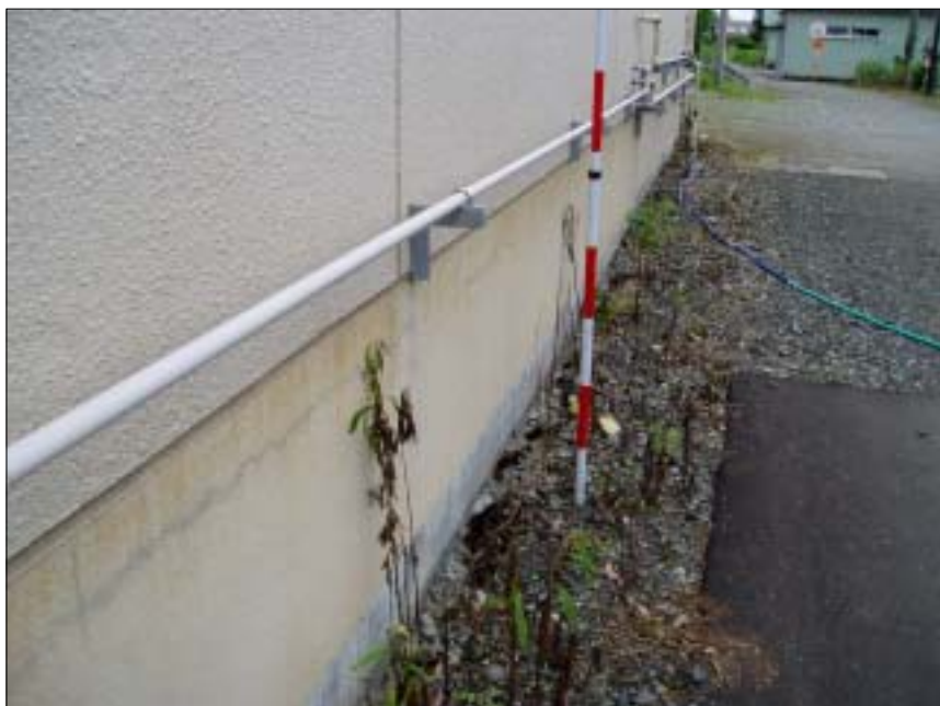
写真名：元城-3、校舎周辺の沈下 撮影箇所：元城町、柏崎総合高校 撮影日：2007年 7月 22日 コメント：河川に隣接している割りに被害が少ない。元城町という名のとおり、総合高校は、城址として比較的良い地盤の上に立っているためか？
