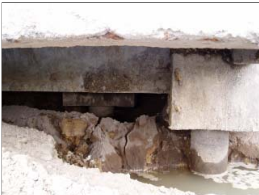
写真名：畔屋-3、建物の基礎 杭の露出 撮影箇所：畔屋地内、かしわ 荘 撮影日：2007年 7月 22日 コメント：建物周辺の沈下に 伴って、多々物下の杭基礎の 頭部が大きく露出している状 況
