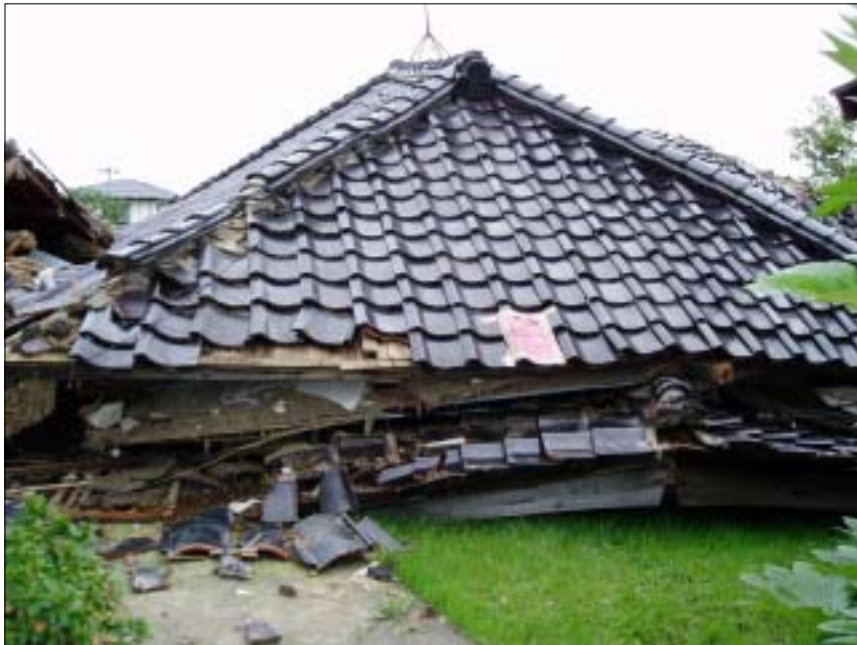
写真名：中道-2、家屋の倒壊 撮影箇所：中道地内、県道73号沿い 撮影日：2007年 7月 22日 コメント：県道脇の古い家屋が完全に倒壊している状況
