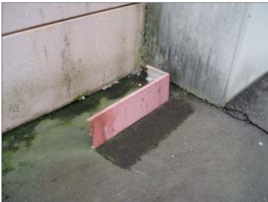
写真名：軽井川-6、落下したカバー 撮影日：2007年 7月 22日 コメント：校舎間を繋ぐ渡り廊下の接続部分に力が集中して破損し、カバーが落下している状況
