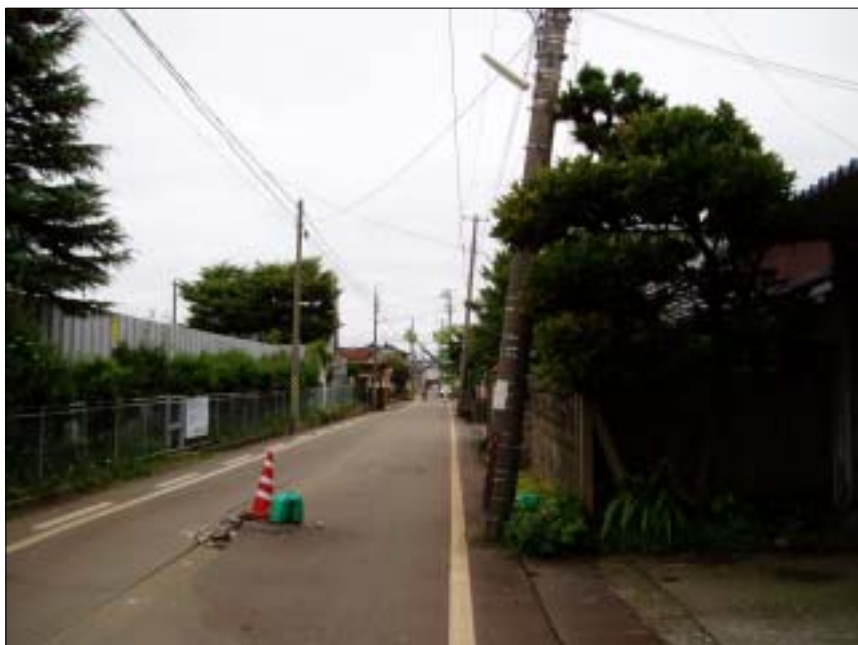
写真名：比角1-3、電柱の傾斜 撮影箇所：比角1丁目地内 撮影日：2007年 7月 22日 コメント：電柱が大きく傾いている他、マンホールも大きく飛び出している。
