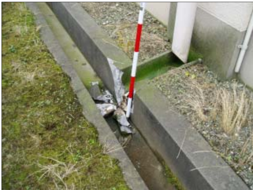
写真名：元城-1、排水路の損傷 撮影箇所：元城町、柏崎総合高校 撮影日：2007年 7月 22日 コメント：排水路が交差する部分で、損傷が見られる状況
