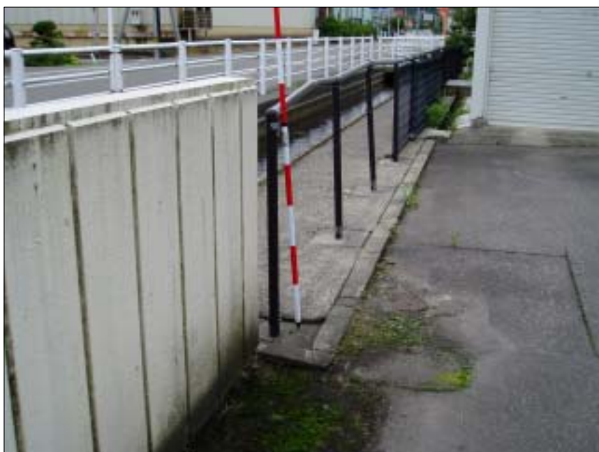
写真名：新道-3、フェンスの損傷 撮影箇所：新道地内、南中学校 撮影日：2007年 7月 22日 コメント：校舎と用水の間にあるフェンスが波打って壊れている状況
