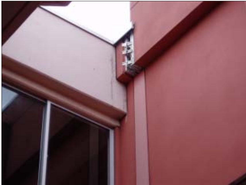
写真名：軽井川-5、渡り廊下接続部の損傷 撮影箇所：軽井川地内、新潟産業大学 撮影日：2007年 7月 22日 コメント：校舎間を繋ぐ渡り廊下の接続部分に力が集中して破損し、カバーが落下している状況
