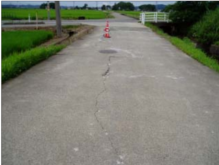
写真名：中田-2、道路の沈下亀裂 撮影箇所：中田地内 撮影日：2007年 7月 22日 コメント：畔屋地内と中田地内の境界を走る道路では、下水の管路に沿って亀裂が入っている。
