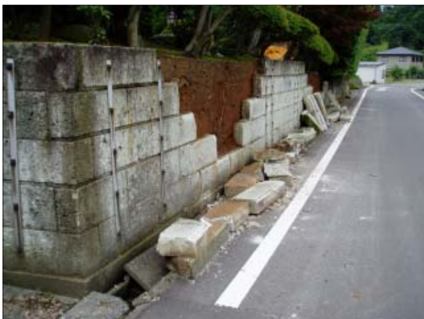
写真名：畔屋-6、石積ブロックの転倒 撮影箇所：畔屋地内、丘陵南側 撮影日：2007年 7月 22日 コメント：転倒防止のために、金具で石を固定してあったが、耐え切れずに転倒している状況
