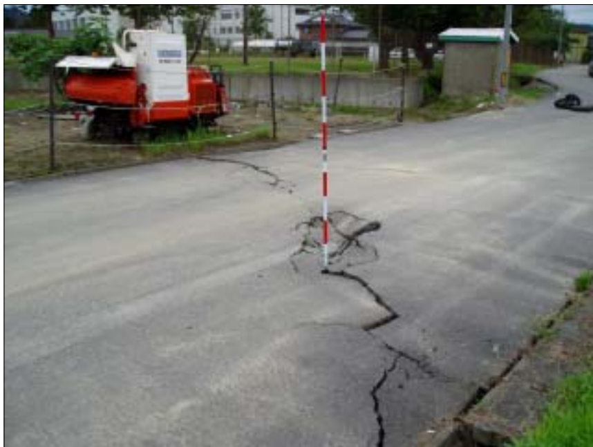
写真名：中田-13、道路のクラック 撮影箇所：中田地内 撮影日：2007年 7月 22日 コメント：道路上には地震動によって発生したクラックが多数見られる。
