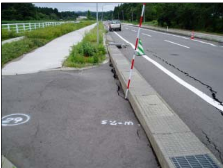
写真名：堀-3、道路の沈下変形 撮影箇所：堀地内、県道73号 撮影日：2007年 7月 22日 コメント：道路が大きく沈下して、可変側溝が飛び出している状況、東方向を臨む
