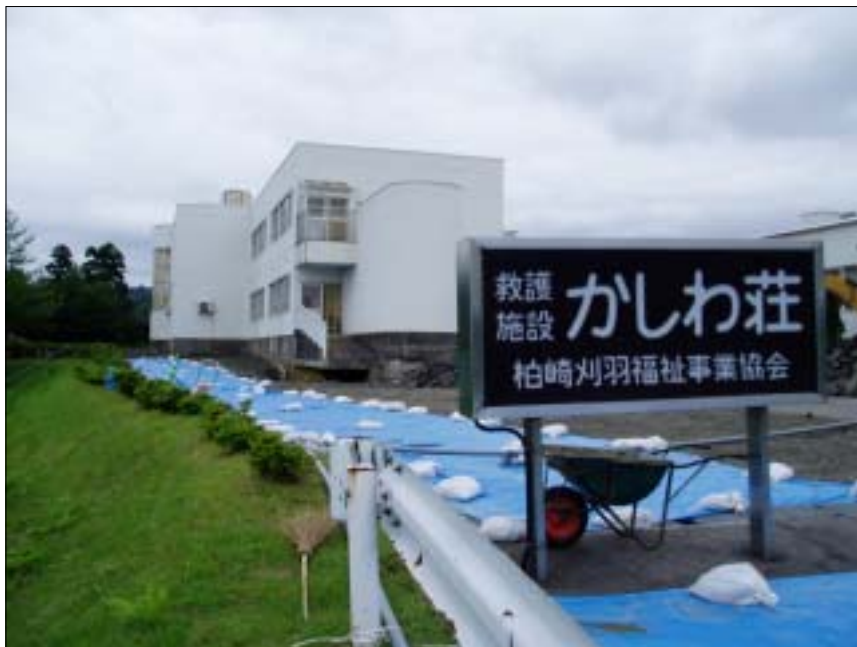
写真名：畔屋-1、法面の沈下 変状 撮影箇所：畔屋地内、かしわ 荘 撮影日：2007年 7月 22日 コメント：かしわ荘は、少し 小高い丘の上にあるが、北側 の法面に変状が生じ、大きな 沈下と亀裂が生じている。
